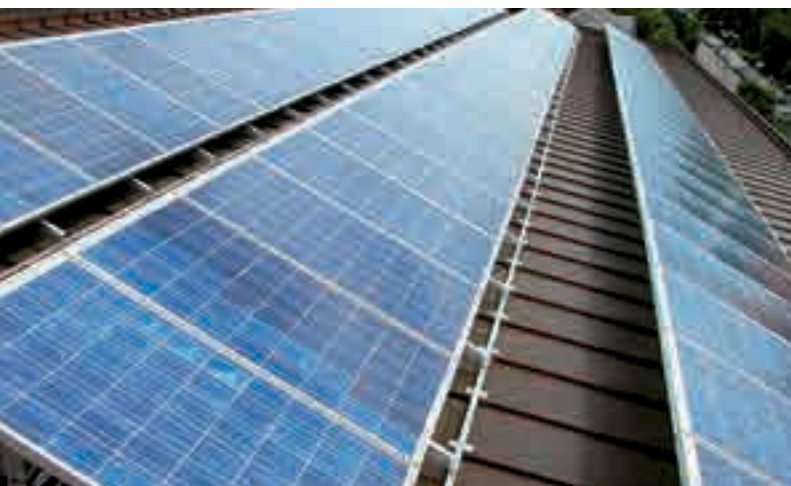
Système de toit photovoltaïque. Garage principal du tramway à Ständlerstraße (Munich). Source : SWM
